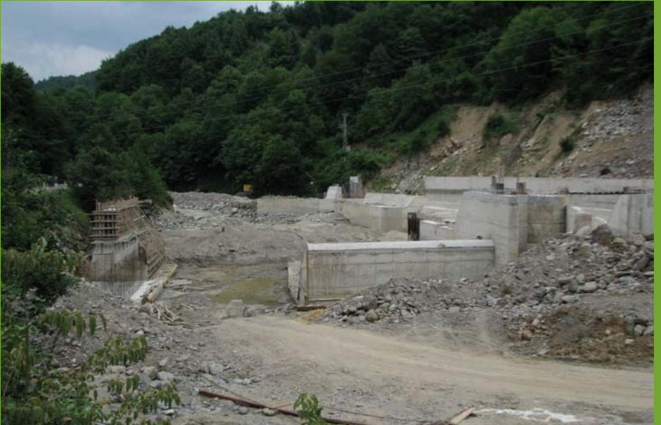
HES inşaatı nedeniyle dere yatağının doğal yapısı tamamen bozulmuştur (Murgul, Artvin)
