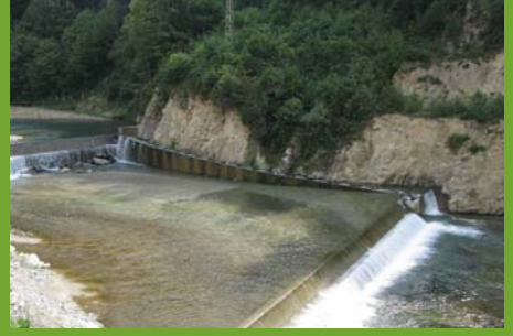
Dereye bırakılan su üzerinde her ne kadar balık geçidi inşa edilmişse de, nehir üzerine beton dökülerek düzleştirme yapılmıştır ve balık geçidini kullanabilen balıklar haricinde diğer canlıların nehir içinde ileri-geri hareketi kesintiye uğramıştır. (Ikizdere Vadisi, Rize)
